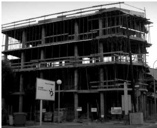
Una obra amb insuficients mesures de seguretat
